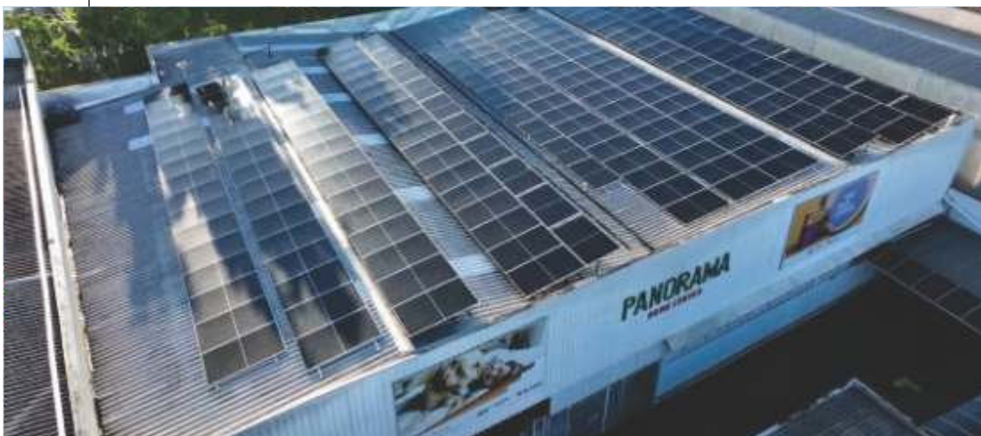
Painéis fotovoltaicos instalados no telhado da Panorama JK.
